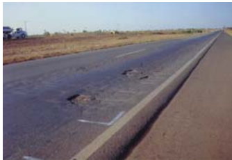
Danos a um pavimento convencional
